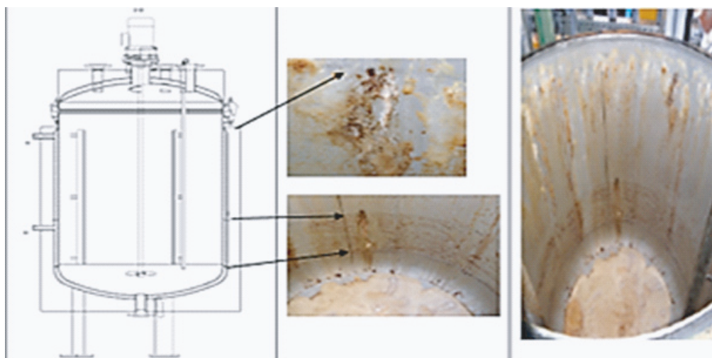
Рис. 4. Коррозионные разрушения системы водоохлаждения импортного оборудования (Германия), выполненного из нержавеющей стали, из-за употребления воды низкого качества (псевдоустойчивой)
