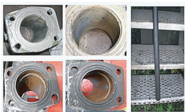
Рис. 11. Состояние системы отопления после обработки
