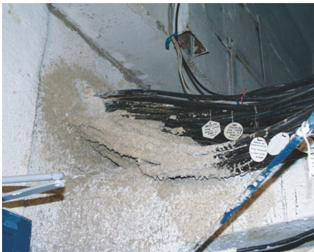
Рис. 1. Попадание цементного раствора на кабели при заделке
