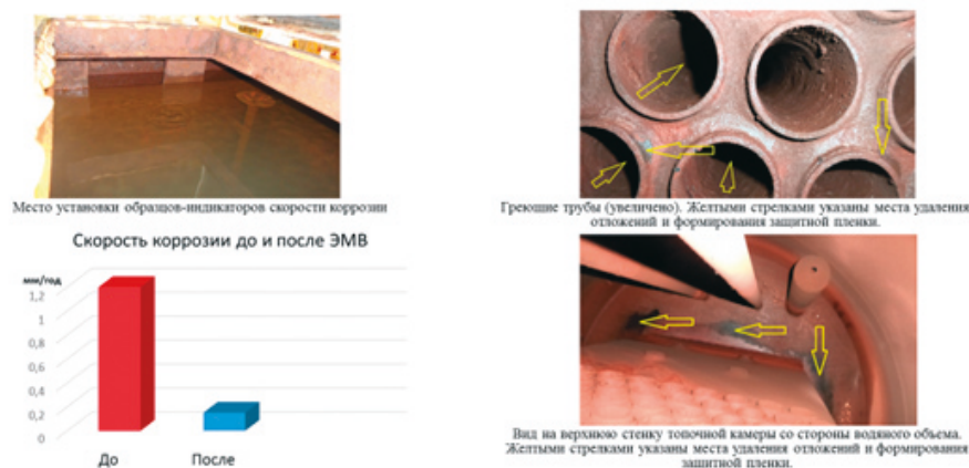
Рис. 9. Изменение состояния водяного тракта котельной судна и некоторых параметров ВХР через 12 месяцев после обработки
